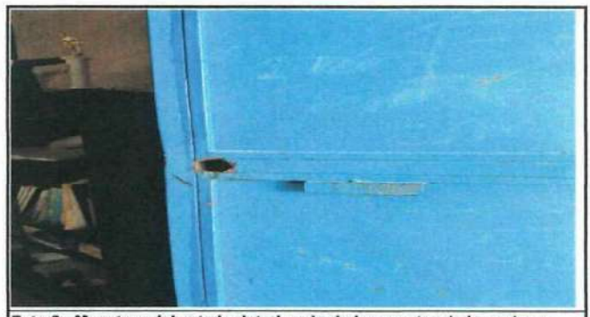
Foto 6: Muestreo del estado deteriorado de las puertas de las aulas y direccion, es necesario la repacion para el mejoramiento y cuidado de las mismas.
