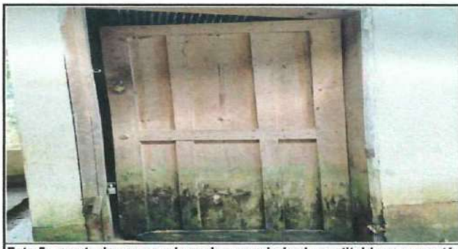
Foto 5: puerta de acceso a la cocina, se priorizado sustituirla ya que está hecha de madera.
