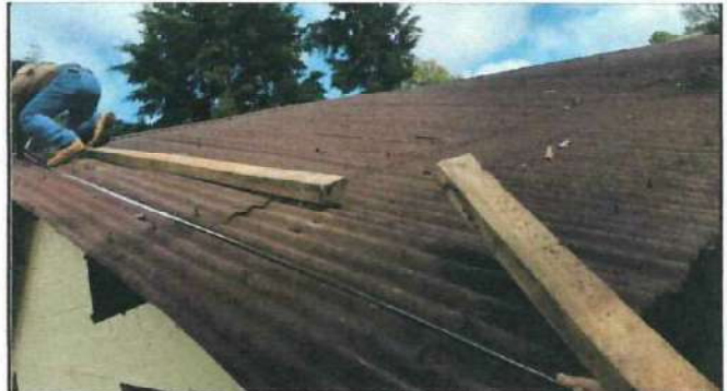
Foto 2: parte trasera del techo en donde se muestra el deterioro en 100%, y en donde se filtra el agua en epocas de lluvia.
