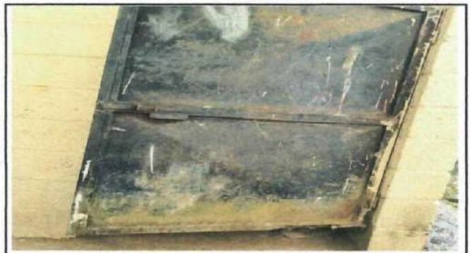
Foto 4: puertas deterioradas de baños para las niñas, estan en mal estado es por eso que es una necesidad sustituir las.
